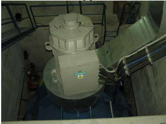
Turbina (630 kW) mHE Prepadnik na Savinji pri Nazarjih
