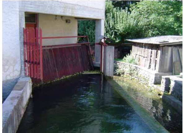
Čistilne rešetke mHE (50 kW), ki deluje v sklopu Brinečevega mlina
