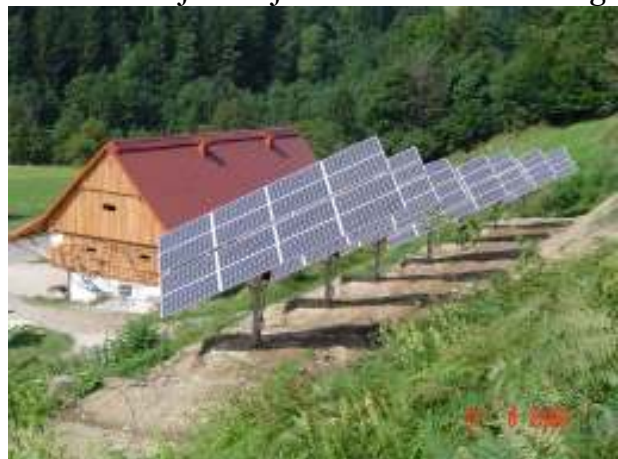
Sončna elektrarna Bukovje
