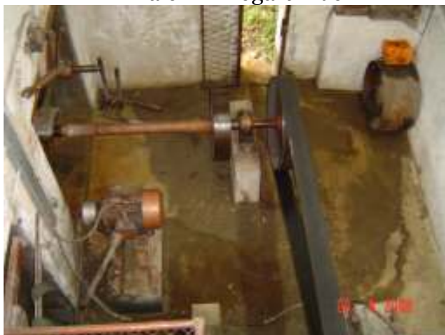
7 kW in 12 kW generator v mHE Podpečnik (Podvolovjek)
